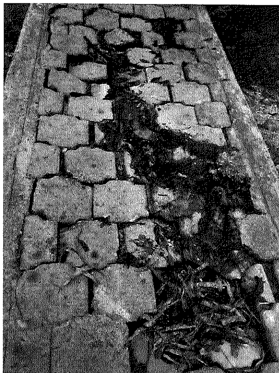
Otro tramo del andador interior, severamente dañado por el paso de los años desde su construcción.
